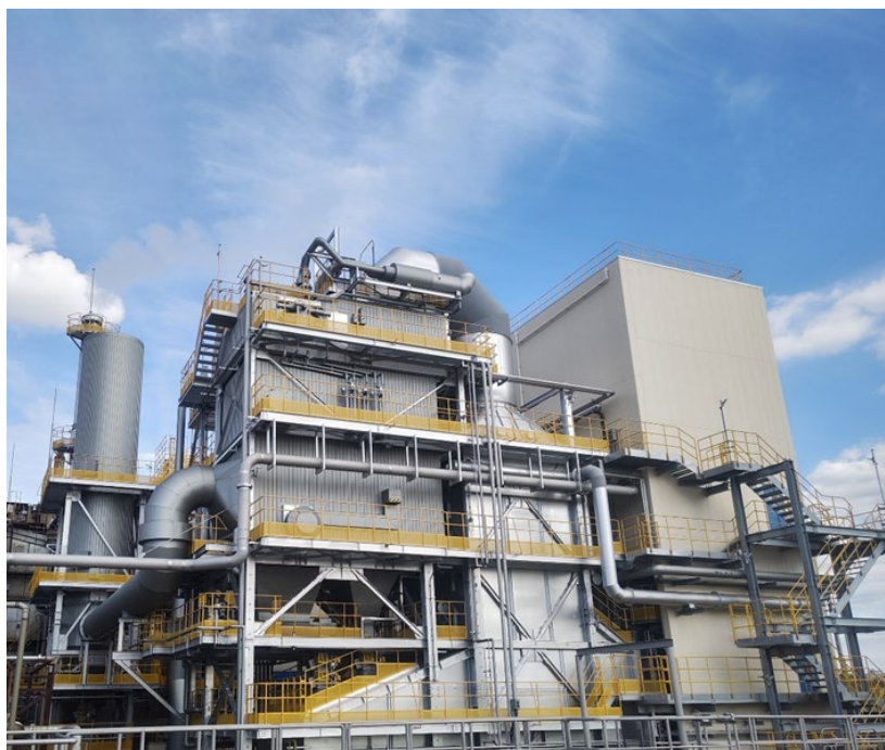
バイオマス焼却設備(尼崎工場敷地内)
