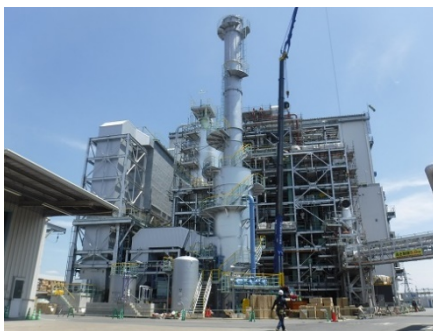
3号ボイラ設備
