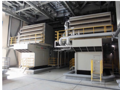
ガスタービン発電設備
