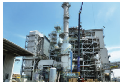
利根川事業所発電用バイオマスボイラ
