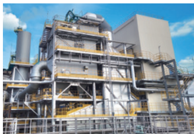
尼崎工場バイオマス焼却設備
